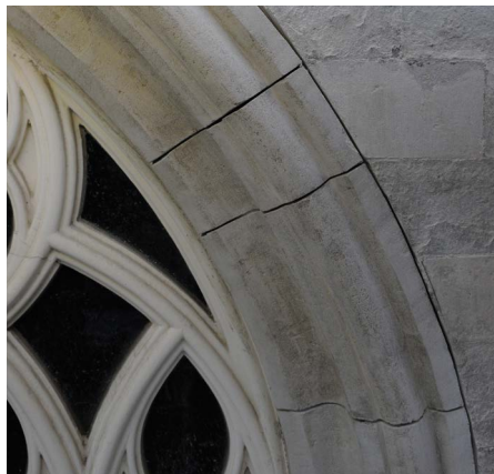
Monulit – Mortier naturel pour la réparation de pierre naturelle – Cathédrale Saint Rombaut Malines
